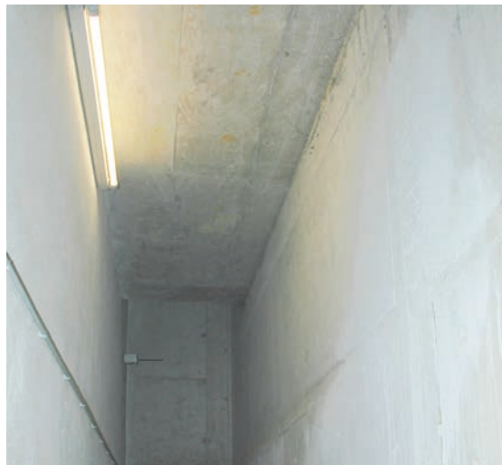
Der Blick in den mehr als 90 Meter langen Erdkanal zur Klimatisierung der Schweinfurter Büroräume mittels Erdwärme und -kühle.
