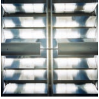
Indirekte Bürobeleuchtung über Breitbandreflektoren.
